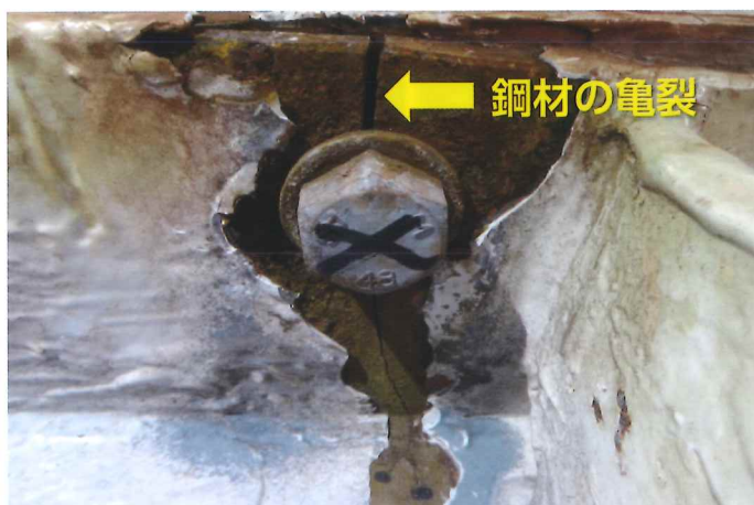
①伸縮装置の腐食状況(路面裏側)
